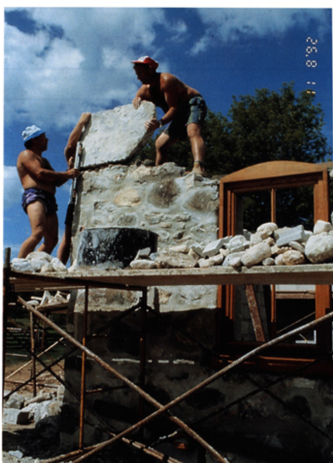
Orlando und Cesar setzen die schweren Ecksteine; Fenster aus Luxemburg werden mit vermauert
