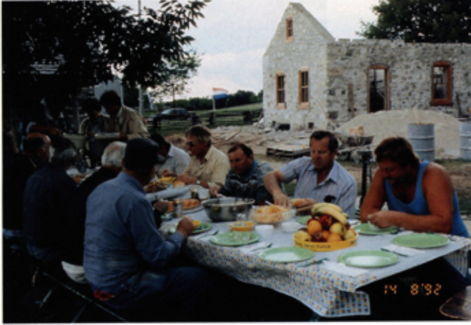
Täglicher Lunch auf der Baustelle von freiwilligen Helfern für freiwillige Helfer und Steinmetzen
